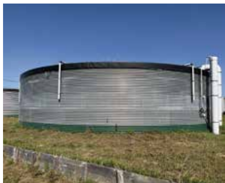
雨水タンク（900 m 3 × 4 基設置）
